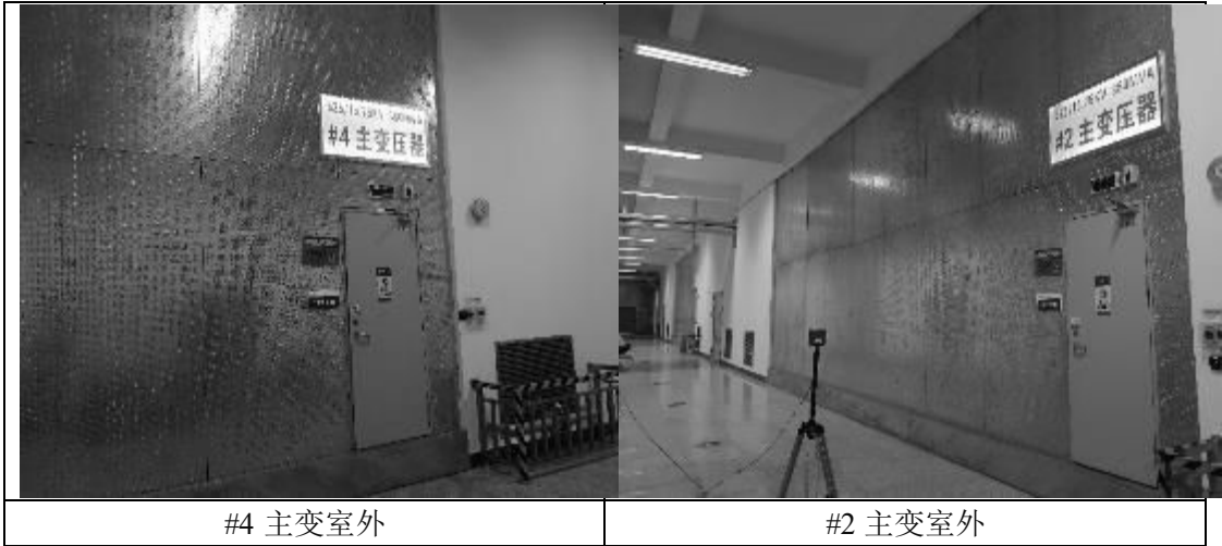
图 6.10-1 清远市抽水蓄能电站 500kV 变电工程现状照片
